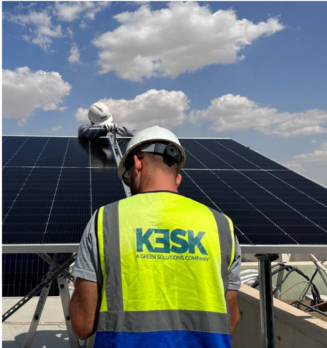
تركيب نظام الطاقة الشمسية الكهروضوئية الهجين في أربيل. أغسطس ٢٠٢٣. المصدر: KESK
